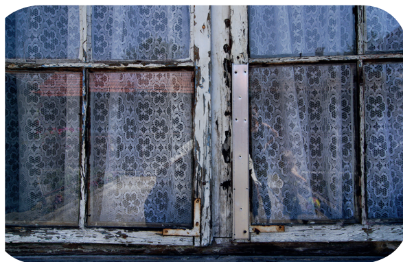
Slika 1: Primjer dotrajalih prozora na zgradi
