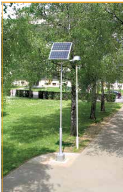
Solarni rasvjetni stup
