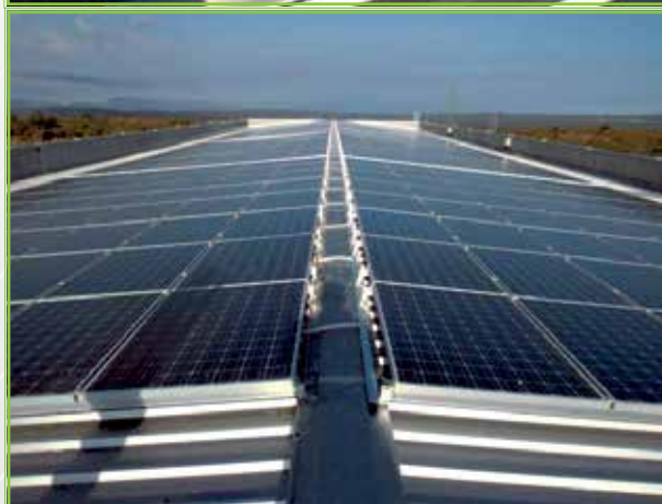
Fotonaponski sustav, Treskavac
