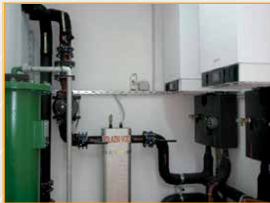
Novo stanje kotlovnice
