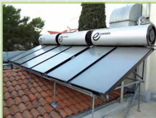
Solarni sustav grijanja potrošne tople vode
