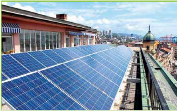
Fotonaponska elektrana na krovu Upravne zgrade Grada Rijeke
