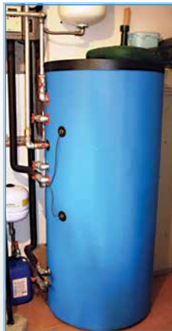
Spremnik za potrošnu toplu vodu
