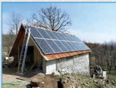
Fotonaoponski sustav na krovu
