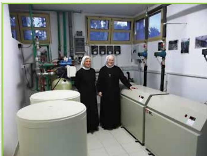
Oprema za dizalicu topline
