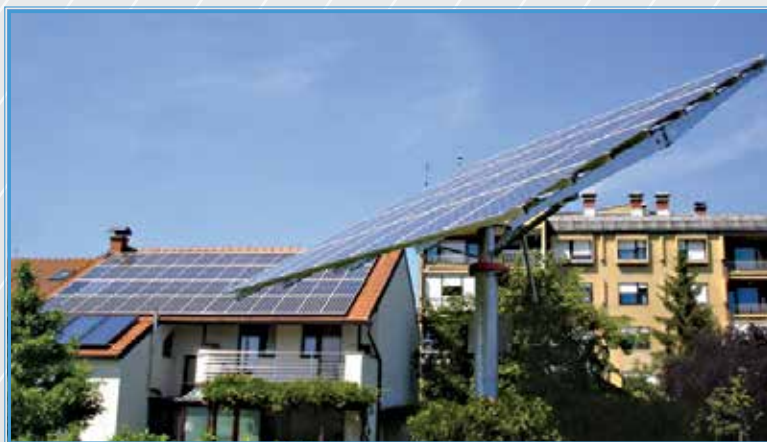
Fotonaponski moduli na krovu i tracking sustavu u Solarnom krovu Špansko
