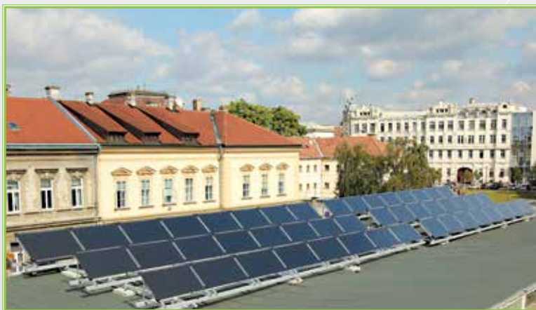
Tržnica Osijek - Solarni paneli
