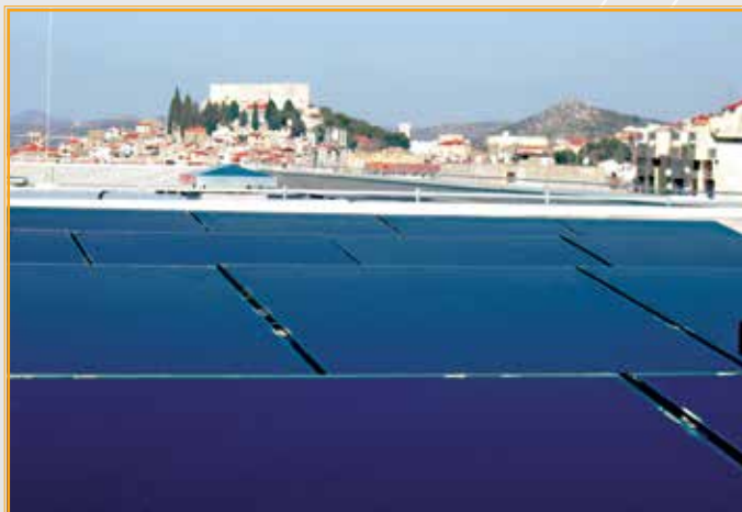
Fotonaponski paneli na krovu Tehničke škole
