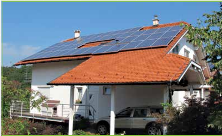
Fotonaponski sustav na krovu elektrane Zelene Remete
