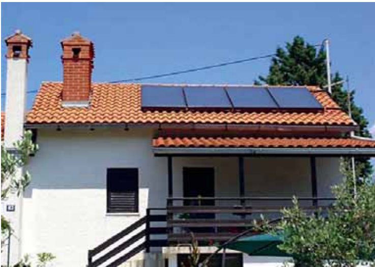
Slika 4. Primjer korištenja Sunčeve energije: sunčani toplinski kolektori
