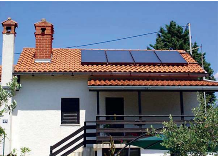
Slika 4. Primjer korištenja Sunčeve energije: sunčani toplinski kolektori
