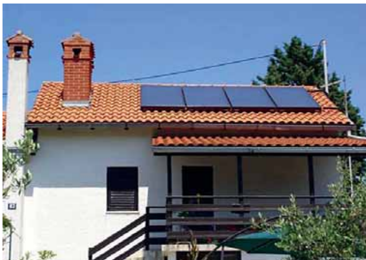
Slika 4. Primjer korištenja Sunčeve energije: sunčani toplinski kolektori
