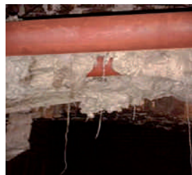
Prikaz [26] Uobičajeni problemi u domovima energetske siromašnih u Srbiji (foto dokumentacija Fractal, 2016.
