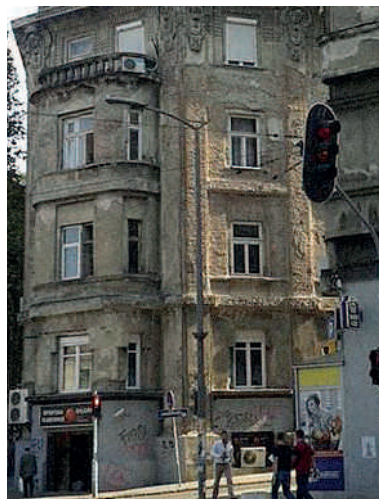
Prikaz [25] Derutne zgrade s lošom izolacijom u Srbiji (foto dokumentacija Fraktala, 2016)
