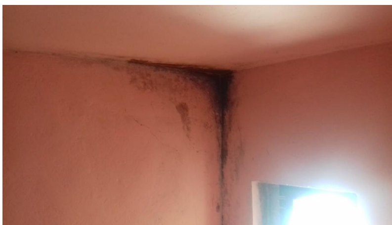
Slika 8 Tipičan primjer pojave plijesni na unutrašnjim zidovima
